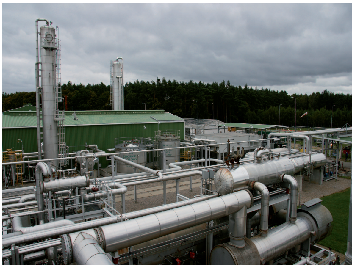
Fot. 2 Widok zakładu do uzdatniania gazu ziemnego w KRNiGZ Dębno (w środku: instalacje odsiarczania o schemacie analogicznym do przedstawionego na rys. 1). Źródło: ZZGNiG (foto: J. Mundry).
